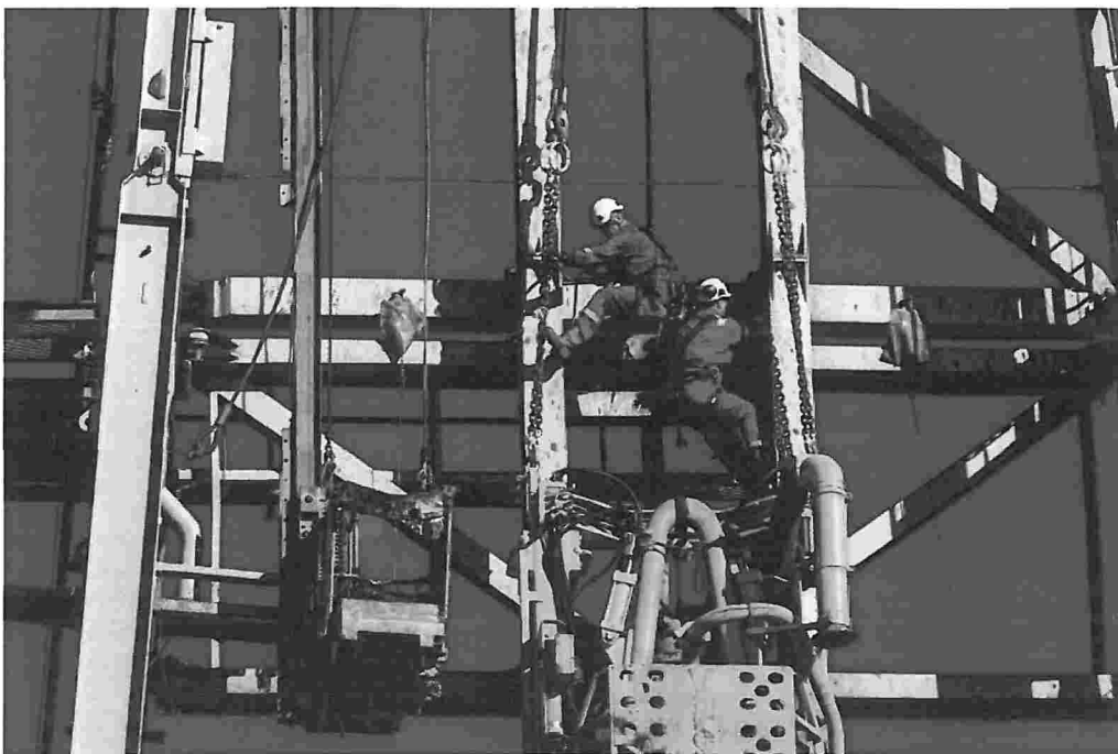
Figuur 5: Demontage van de boortoren op oostelijk deel van de Bergermeerlocatie, demonteren top drive fase 1
