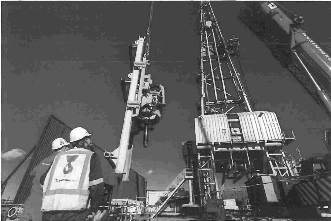
Figuur 6: Demontage van de boortoren op oostelijk deel van de Bergermeerlocatie, demonteren top drive fase 2
